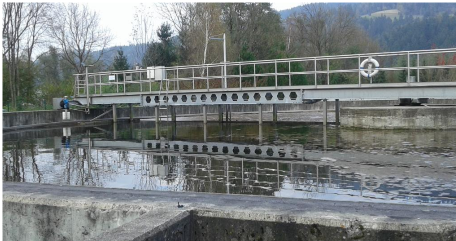
Slika 4: Usedalni bazen primarnega čiščenja.
